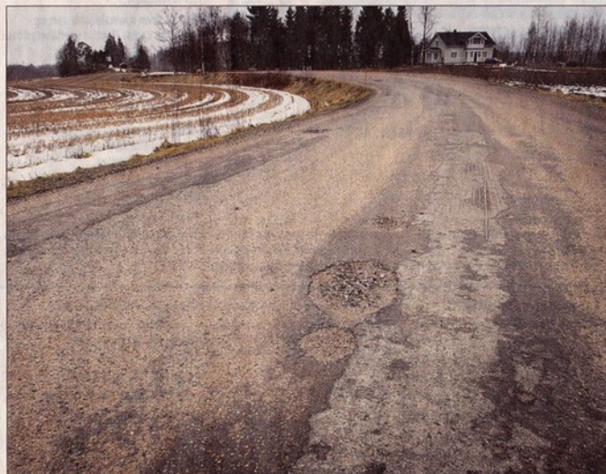
Kuluva talvi on rasittanut teiden päällysteitä, jotka muutenkin ovat rapistuneet hiljaisemmilla tieosuuksilla.
