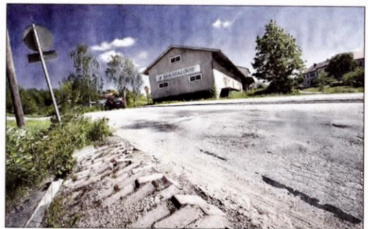
Perniön aseman kohdalla Aimontapontie on reikäinen ja mooneen kertaan paikattu. Lisäksi näkyvyys risteyksessä on huono.
